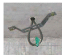
Zestaw montażowy dla wind zastosowany w nadszybiu
